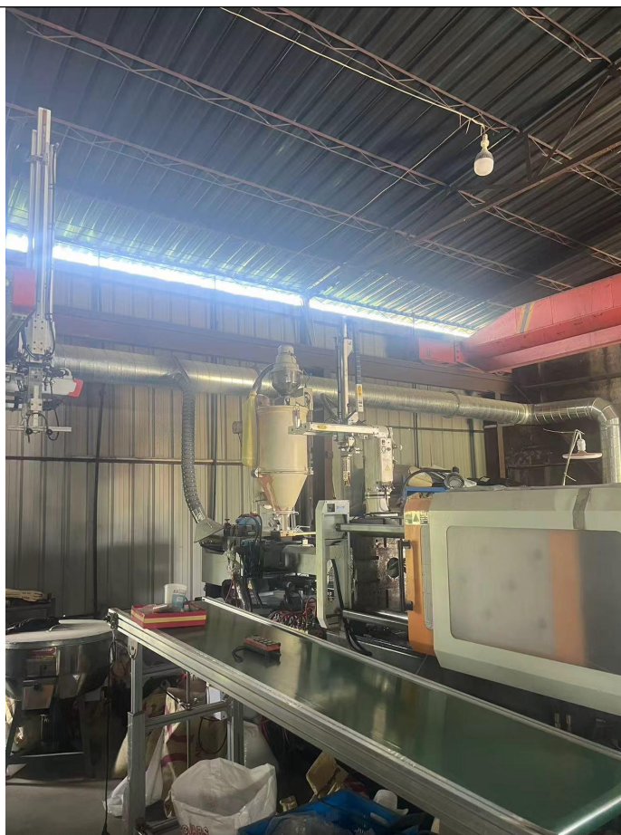
15m 高排气筒
