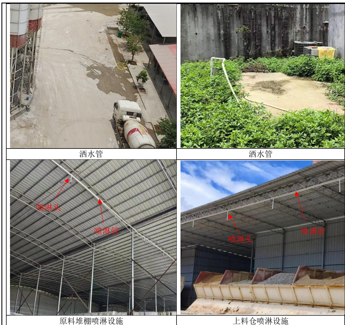
图5-1 废气治理设施
