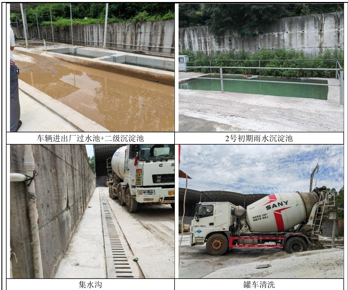
图5-3 项目废水治理设施
