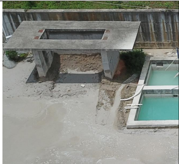
粉渣沥干区（雨天顶部加盖防雨篷布）
