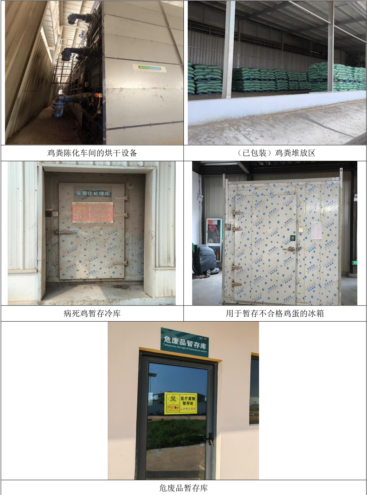
图4.1-3固体废物防治设施
