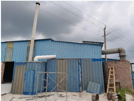
1#两级喷淋、布袋收尘、15m排气筒
