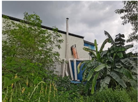
2#两级喷淋、布袋收尘、15m排气筒
