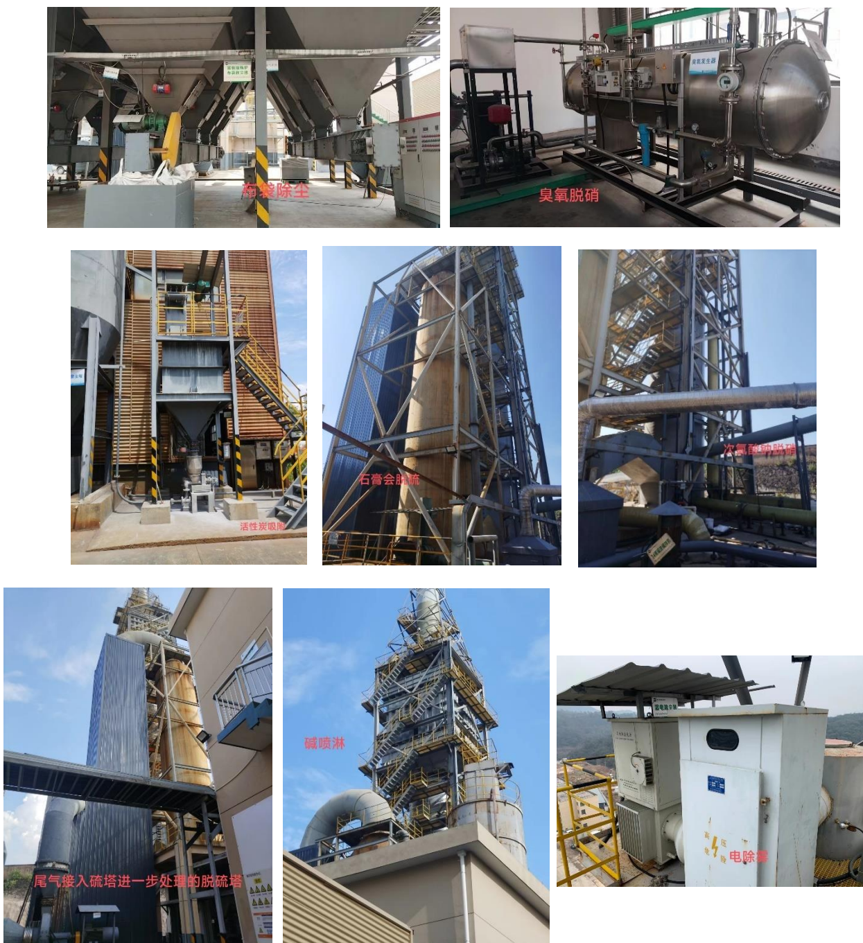
图 4.1-5 本次验收工程熔炼炉废气重力除尘、表冷、活性炭吸附、布袋除尘设施及合并废气臭氧脱硝、石灰石-石膏脱硫、次氯酸钠脱硝、碱喷淋、电除雾设施照片
