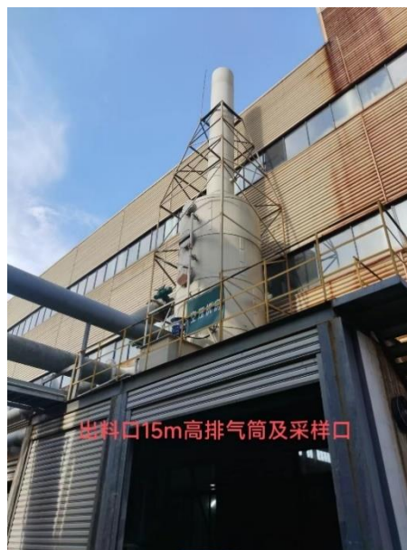
图 4.1-6 本次验收工程出料口废气布袋除尘设施、排气筒及采样口照片
